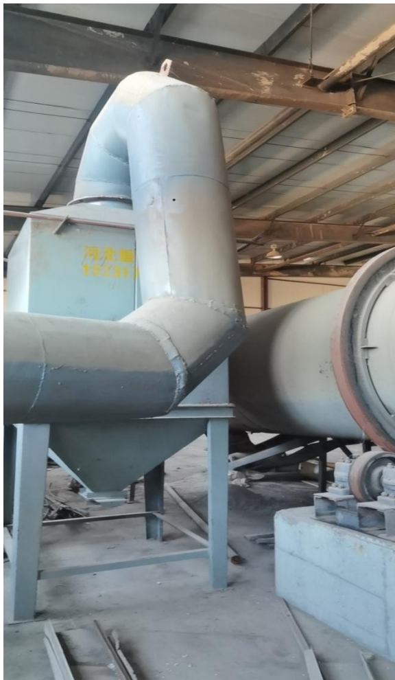
冷却机除尘器
