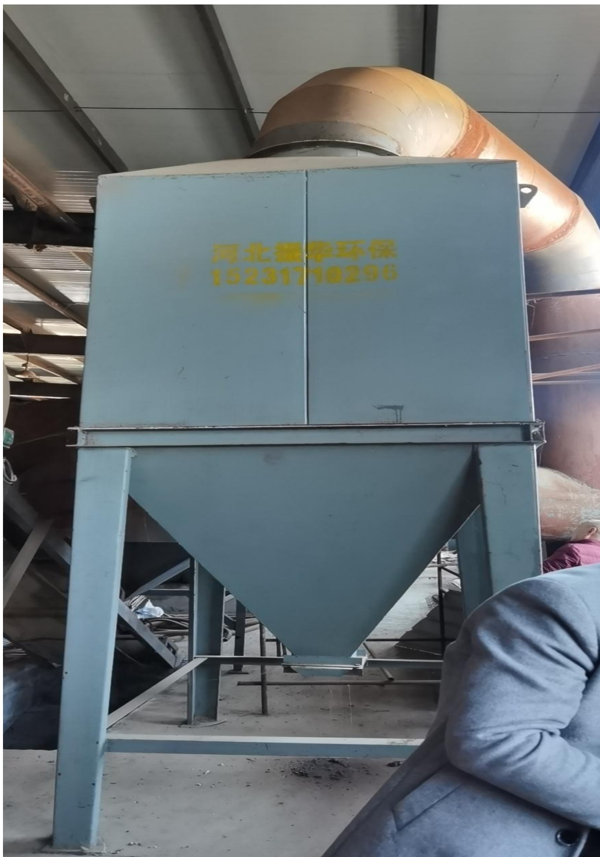
造粒工序除尘器
