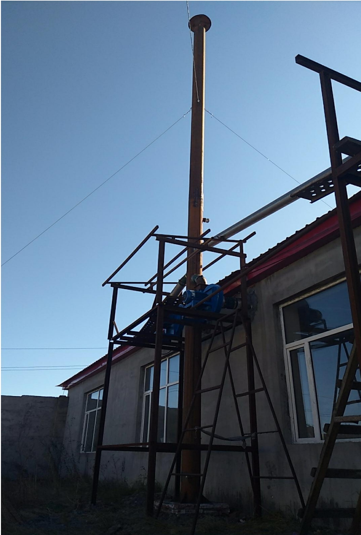
车间 15m 高排气筒
