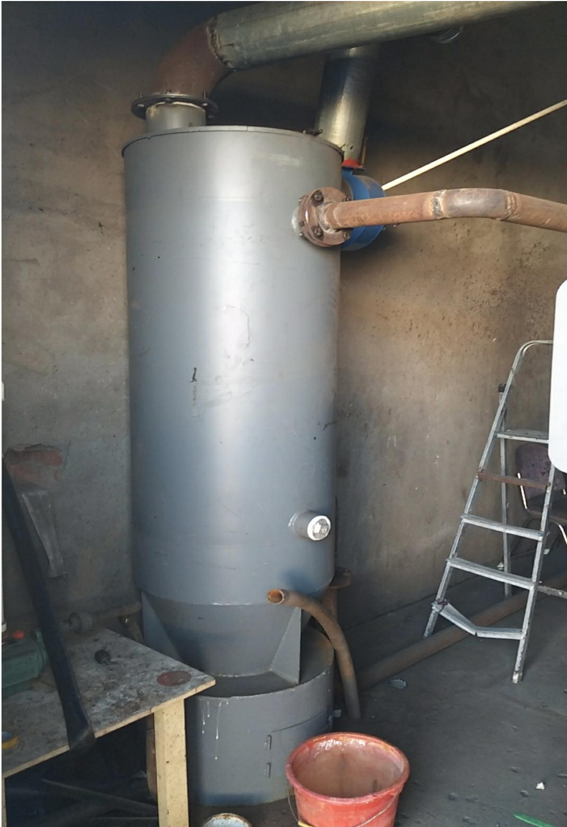
生物质锅炉布袋除尘器
