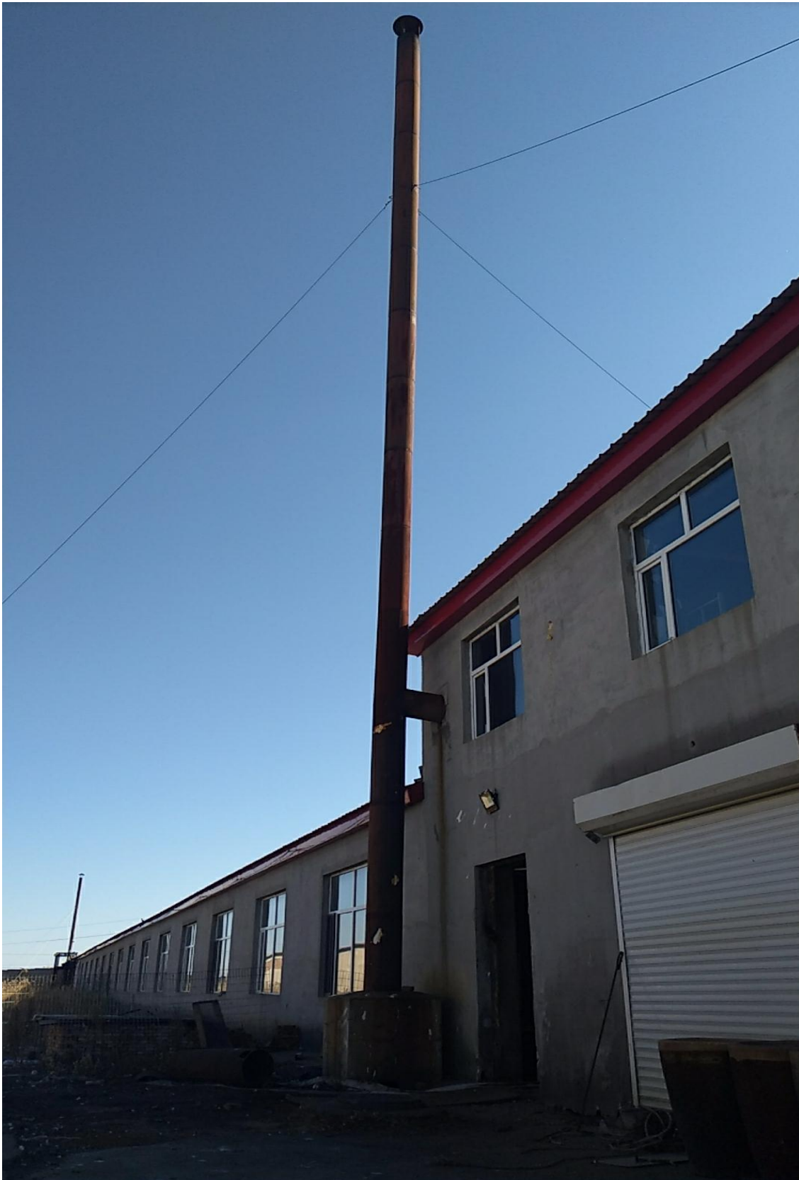
生物质锅炉 20m 高空排放
