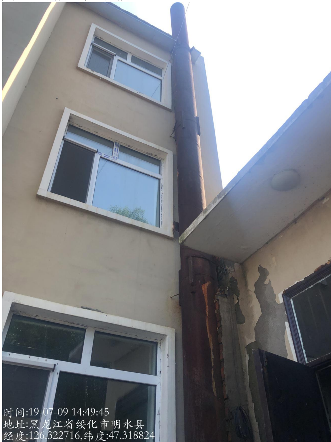
附图：锅炉烟尘高空排气筒
