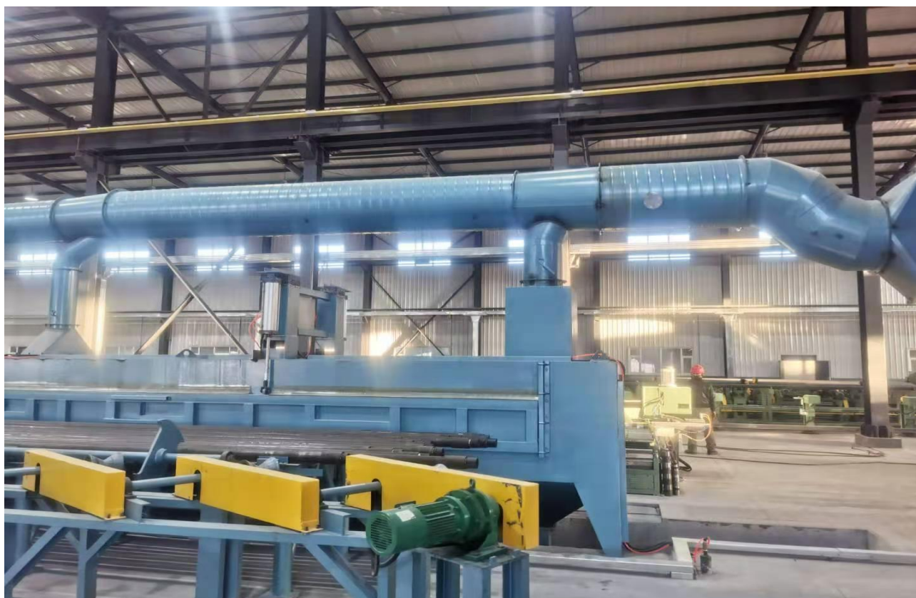
抛丸工艺废气处理前监测口
