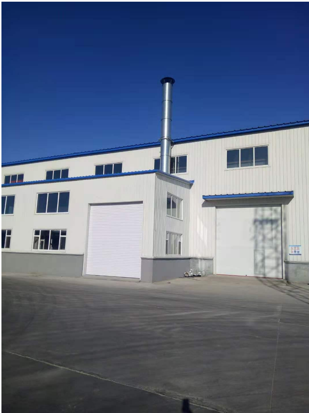
喷漆工艺 15 米高排气筒
