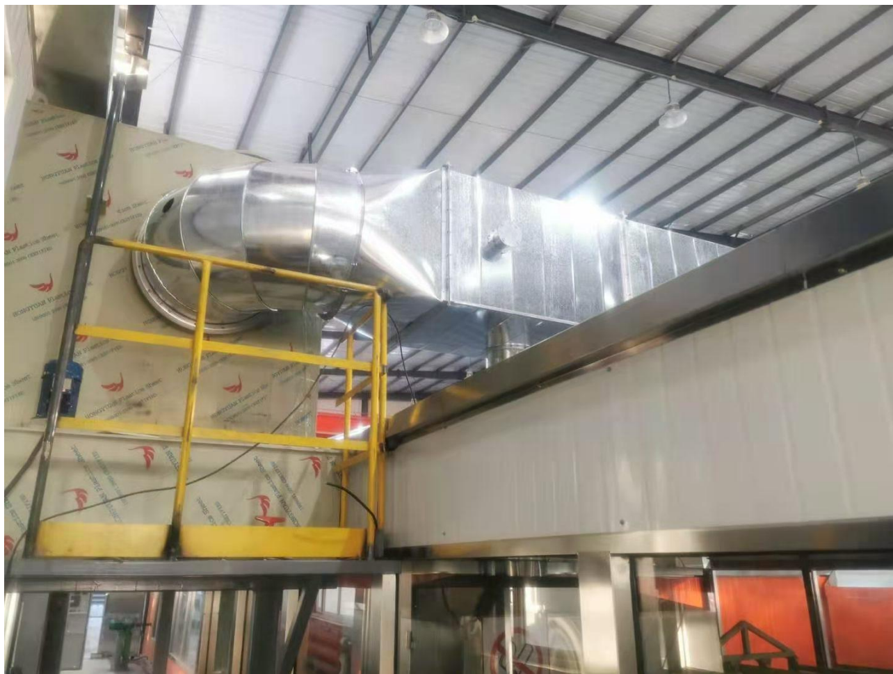
喷漆工艺废气处理前监测口
