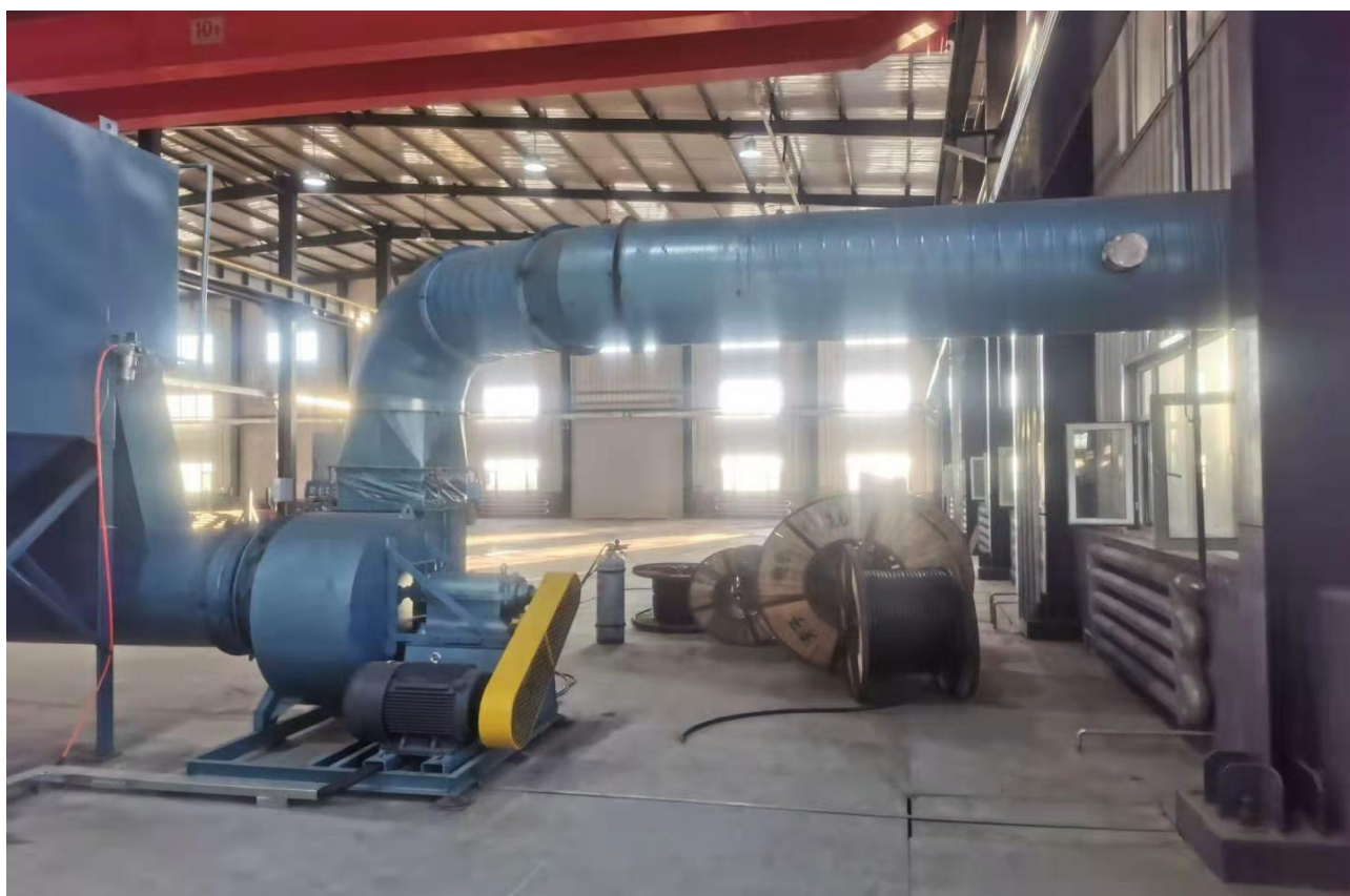
抛丸工艺废气处理后监测口
