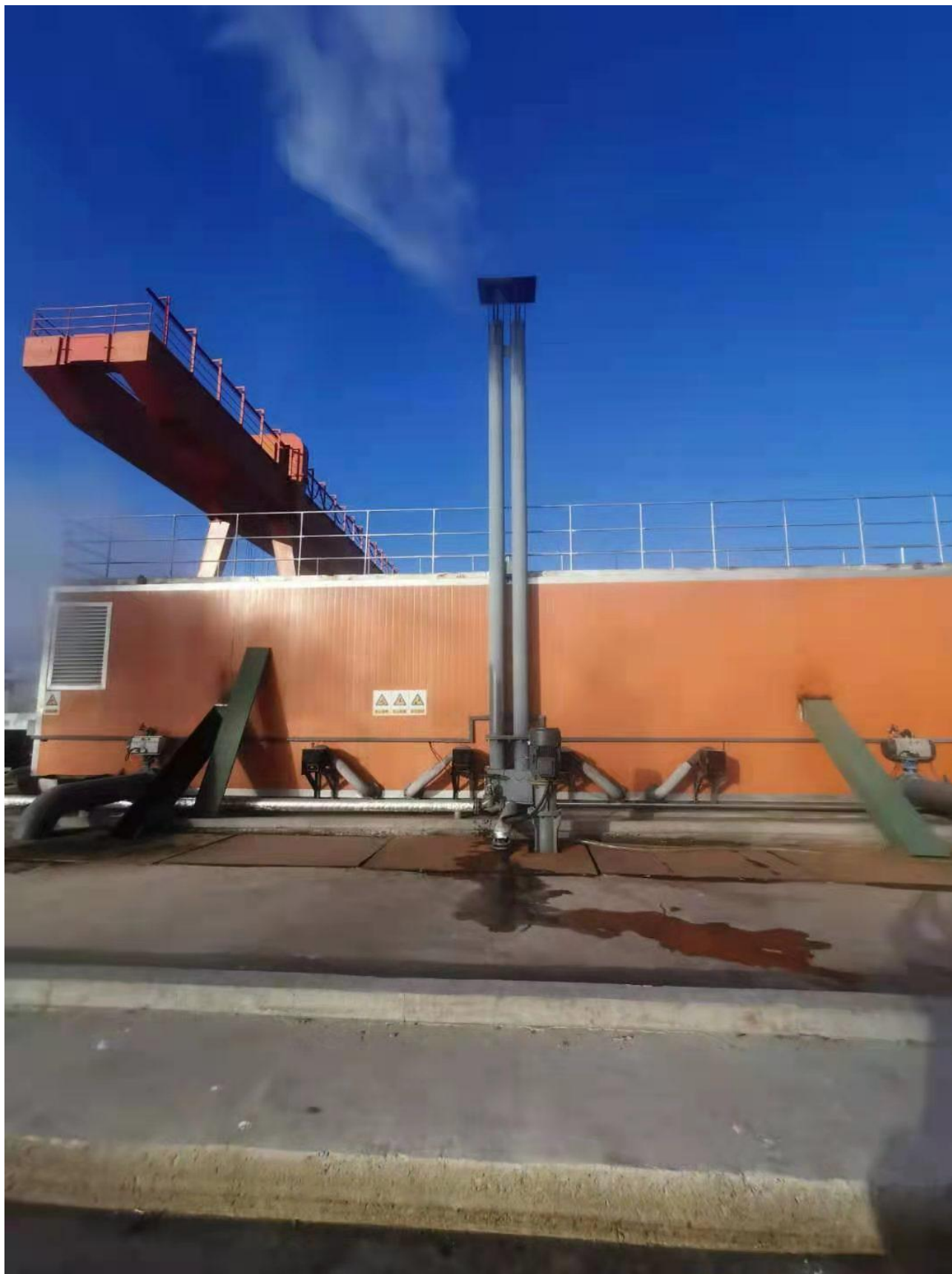
燃气锅炉 8 米高排气筒
