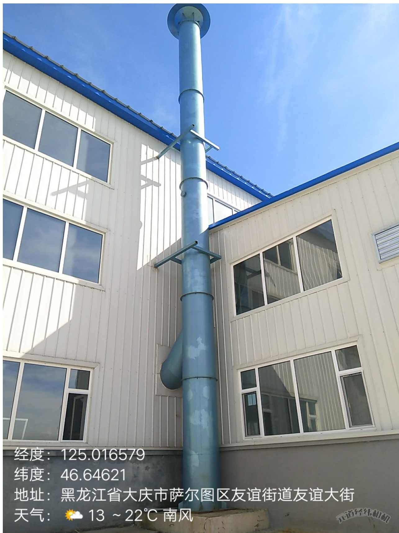
抛丸工艺 15 米高排气筒
